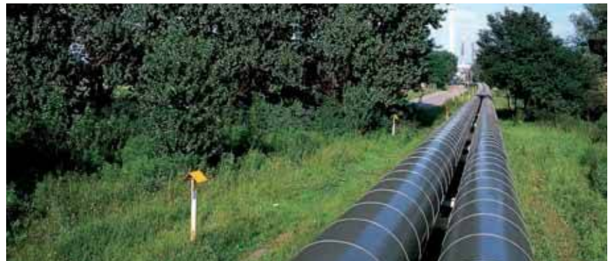
Abb. Fernwärmenetz | STEAG Fernwärme GmbH
