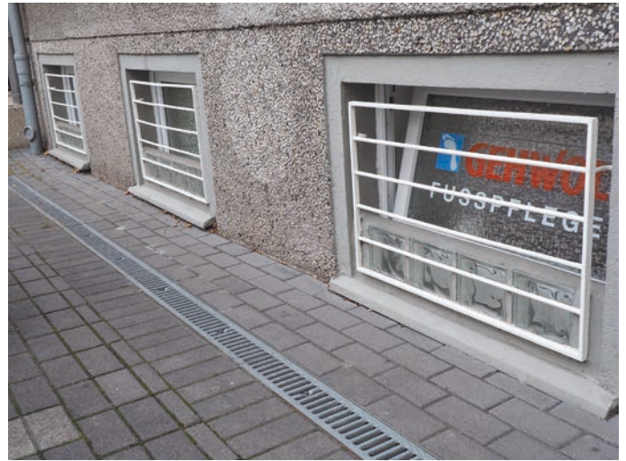
Private Klimafolgenanpassung: Dieser Keller ist vor eindringendem Wasser geschützt. Foto: Stadt Dortmund
