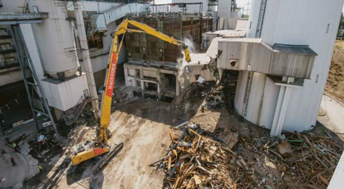
Der Abriss des ehemaligen Steinkohlekraftwerks Gustav Knepper ist bereits in vollem Gange
